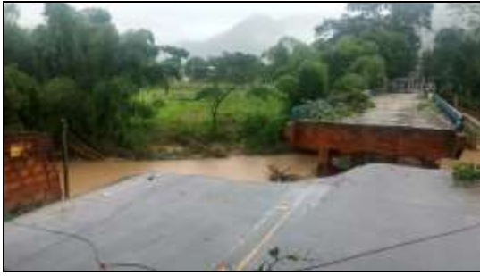
Figura 11: Desabamento de parte da ponte em Trapiche, distrito de Macaé - Foto: Paulo Henrique Cardoso
