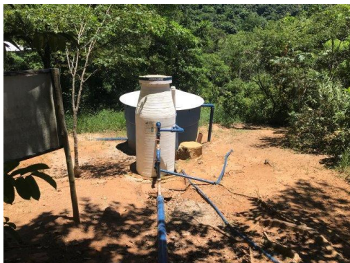
Reservatório e filtro
