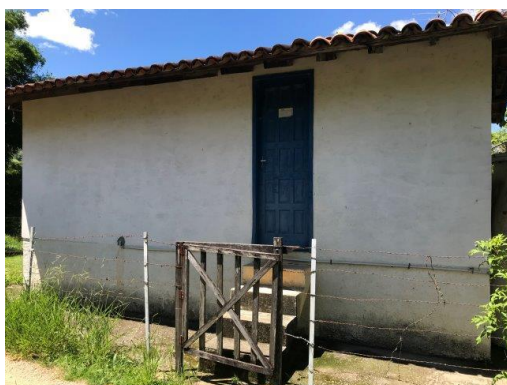
Reservatório e filtro - Captação Palmital
