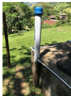
Clorador - Captação Glória
