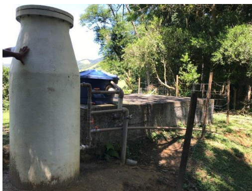
Reservatório e filtro - Captação Glória
