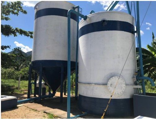
Floco-decantador e filtro
