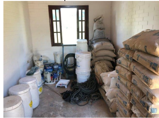
Armazenamento de produtos químicos
