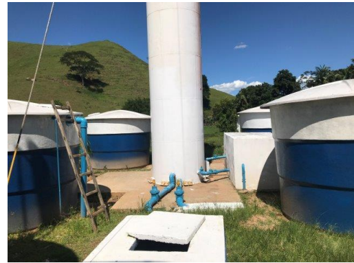
Tanque de contato
