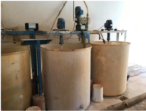
Preparo e dosagem de produtos químicos
