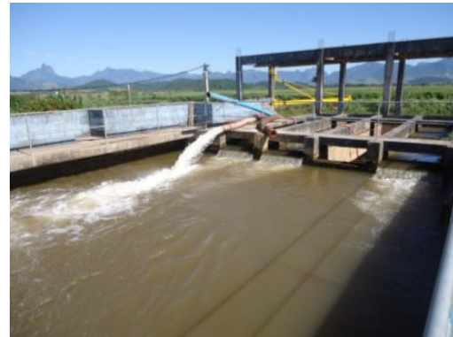
Poço de sucção - alto recalque
