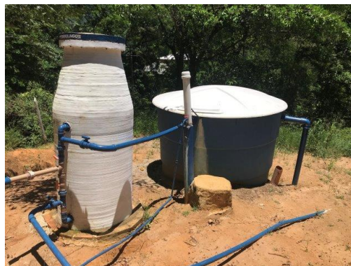
Reservatório e filtro
