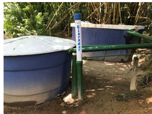
Reservatórios e clorador
