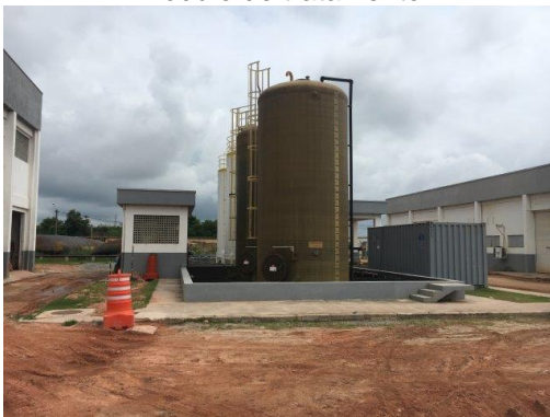
Tanques de produtos químicos
