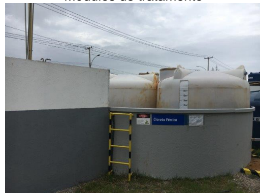
Tanques produtos químicos - coagulante
