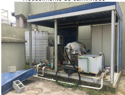
Desidratação do lodo
