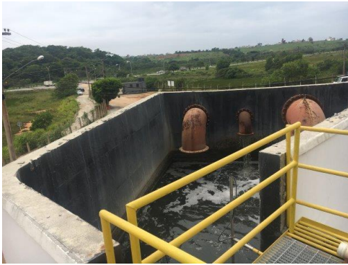
Chegada esgoto bruto
