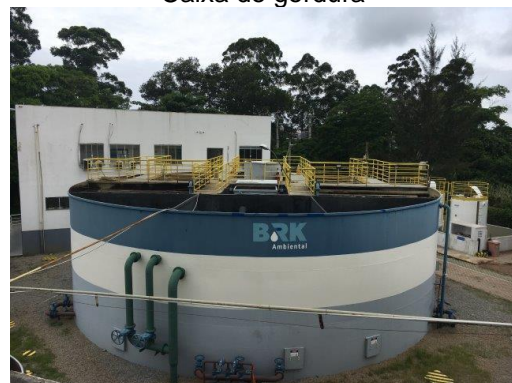
Módulos de tratamento
