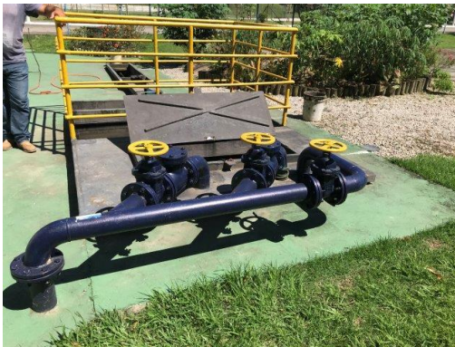
Elevatória de esgoto bruto
