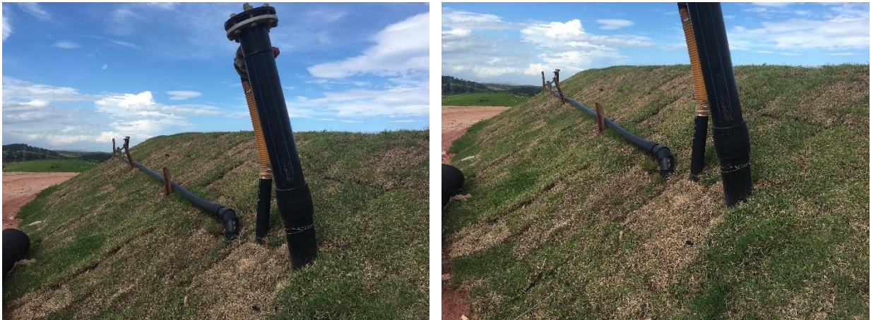
Figura 58 - Drenos de captação de gás. Fonte: SERENCO.
