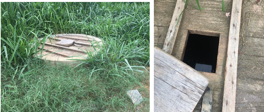
Figura 114 - Tanque de armazenamento de chorume. Fonte: SERENCO.
