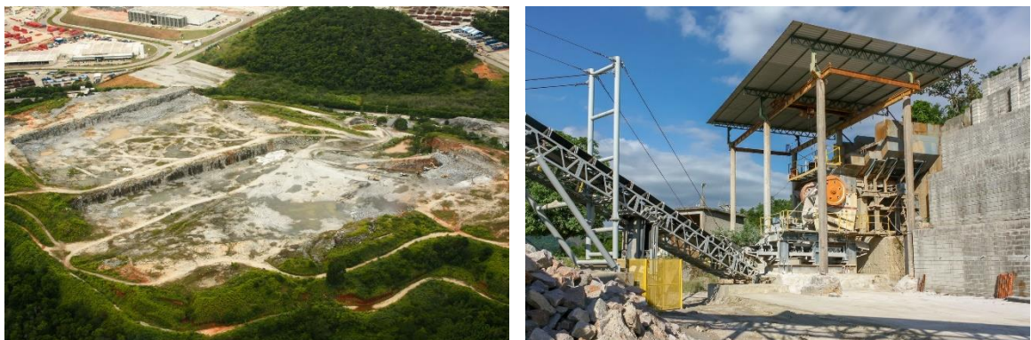
Figura 90 - Área de beneficiamento e britador.
