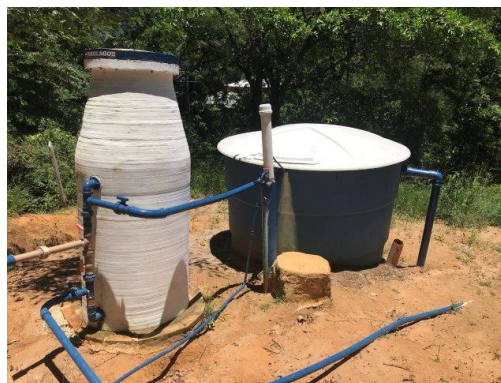
Reservatório e filtro
