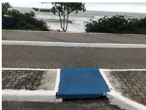
Recolhimento da água pluvial por bueiro
