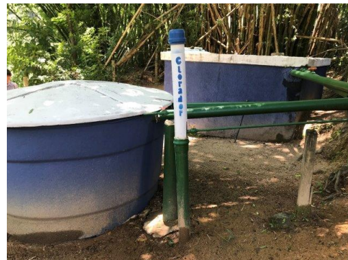
Reservatórios e clorador
