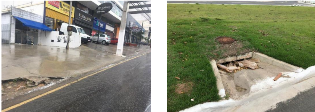
Figura 21 - Microdrenagem sem manutenção.
