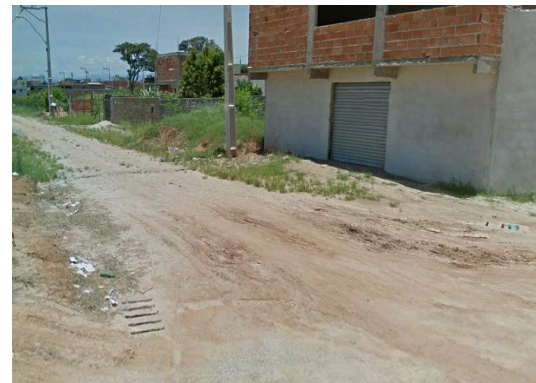
Via sem pavimentação com boca de lobo
