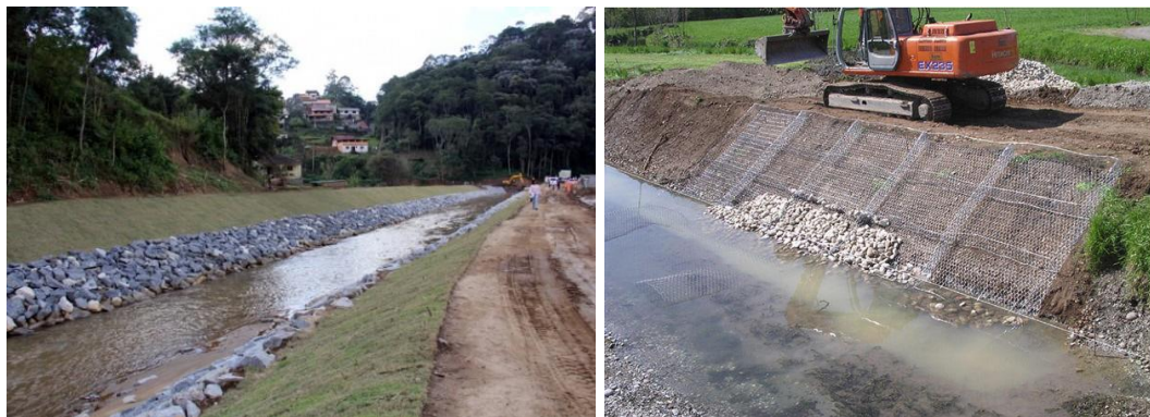
Figura 99 - Exemplos de proteção dos taludes em córregos.
