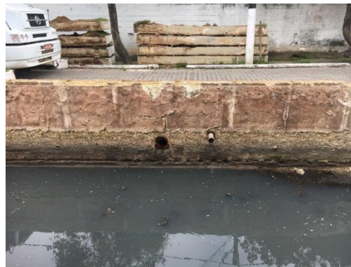
Figura 36 - Lançamento de esgotamento sanitário no canal dos Jesuítas.
