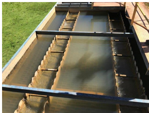
Decantador da ETA
