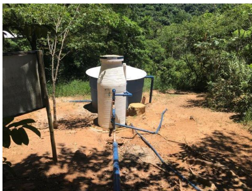
Reservatório e filtro
