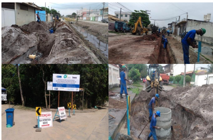
Figura 12- Obras de Extensão de Rede de Esgotamento Sanitário de Rio das Ostras – Rua Joaquim José da Caridade e Loteamento Village. Fonte: CILSJ
