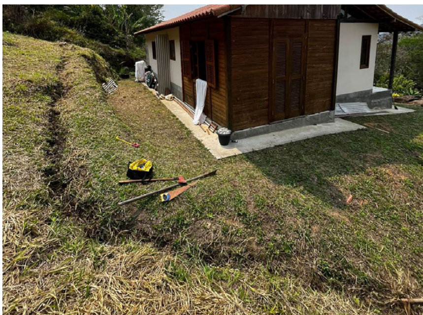
Figura 6 - Canaletas para direcionamento da água pluvial Fonte: Aplicar Engenharia, 2024.
