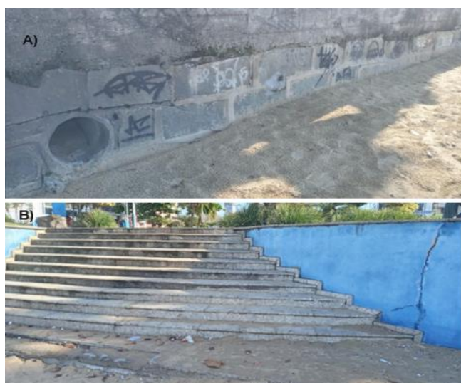
Figura 21: Limite com a retropraia na praia do Centro. A) Parede em concreto com rachaduras. B) Escada de acesso principal à praia na Praça José Pereira Câmara com degraus sem o granito.
